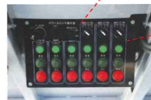
パワーユニットパネル
