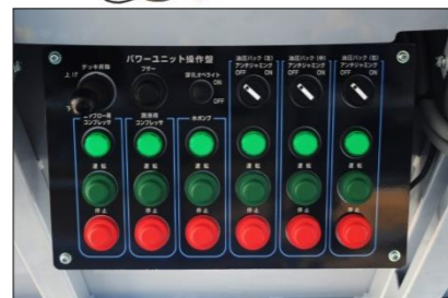
3ブームパワーユニット操作パネル
