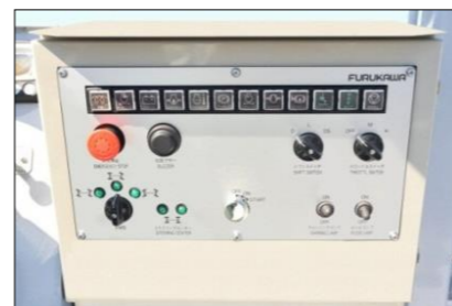
メータパネル部
