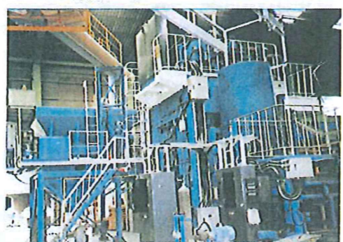
二次製品工場でのモルタルプラント
